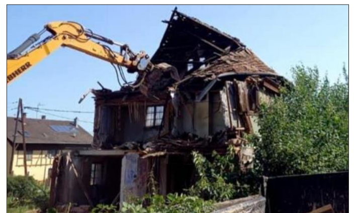
L'Asma dénonce une « démolition sauvage », la commune n'ayant pas respecté le délai légal qui aurait permis de déposer un recours devant le tribunal administratif. DR
